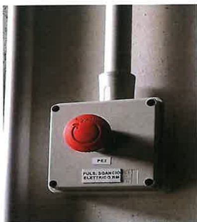
Fig. 3) sgancio elettrico (locale tecnico)
