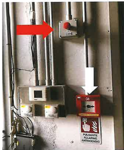
Fig. 2) localizzazione pulsanti nel vano tecnico
