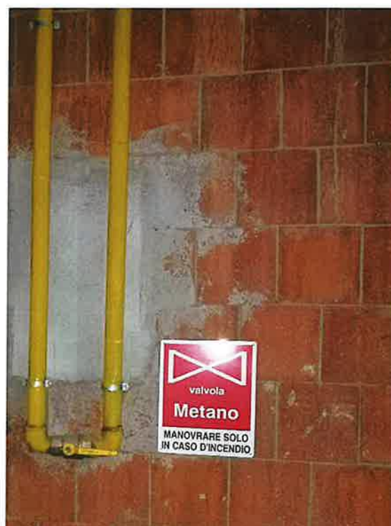
Valvola di sezionamento esterna gas metano cucina posizionata al piano seminterrato
