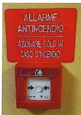
Vista di pulsante di allarme manuale
