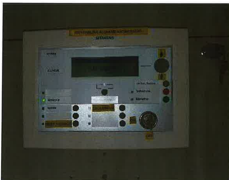
Vista della centralina rilevamento incendi
