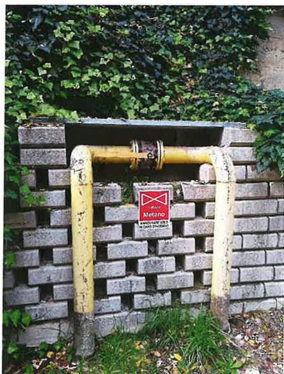
Valvola di sezionamento esterna gas metano posizionata di fronte al laboratorio analisi al piano terreno
