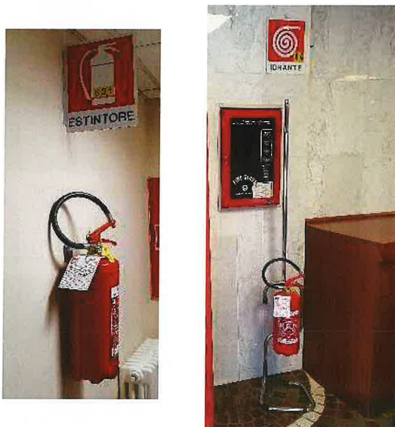
Vista di alcuni estintori installati
