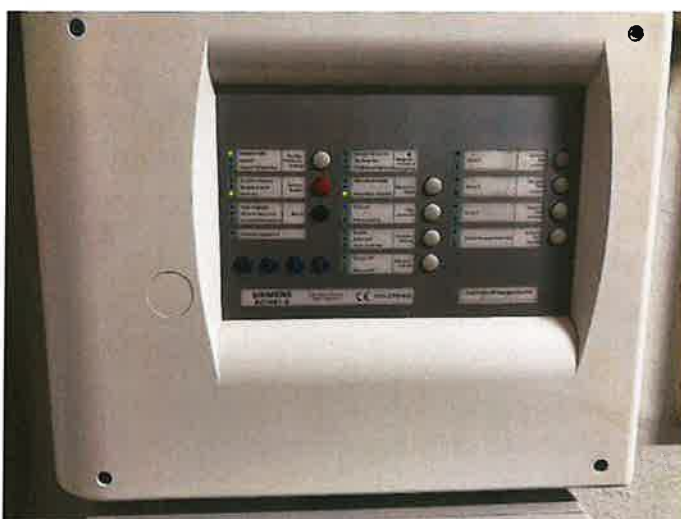
Centralina di rilevamento e spegnimento incendio
